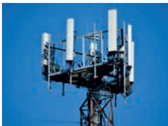
Torre de celular 5G tornará cada vez mais os modems desnecessários.
